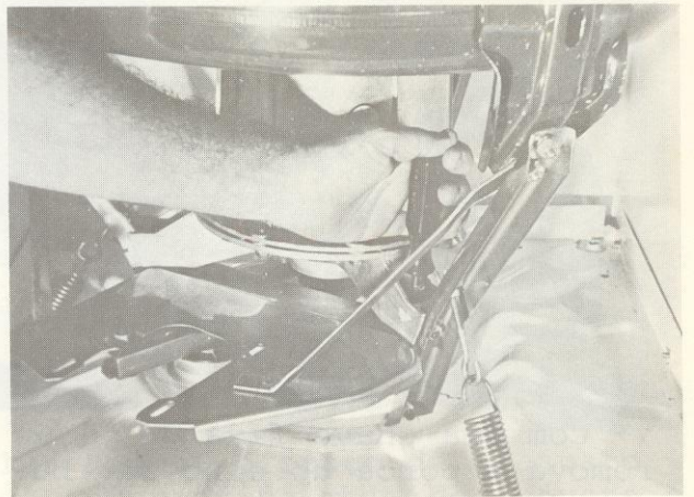
2- Com uma chave canhão de 1/2" retire os dois parafusos que fixam a base do motor à transmissão.
