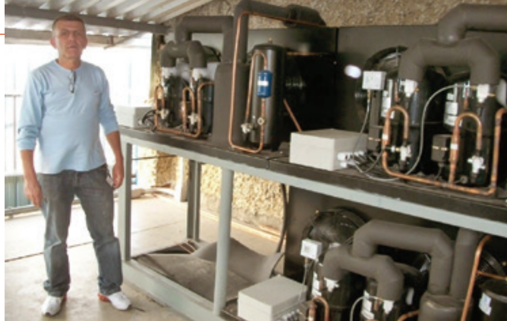
Ronildo Santos Oliveira mostra unidades condensadoras Tecumseh instaladas
