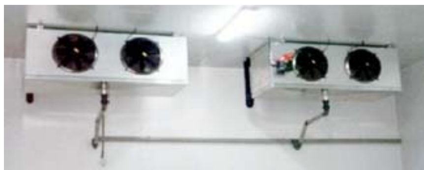
Figura 3.4 – Evaporador para resfriamento de ar (câmaras frigoríficas)
